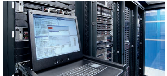
Die IT-Zentrale – unser Rechenzentrum in Ispringen.
